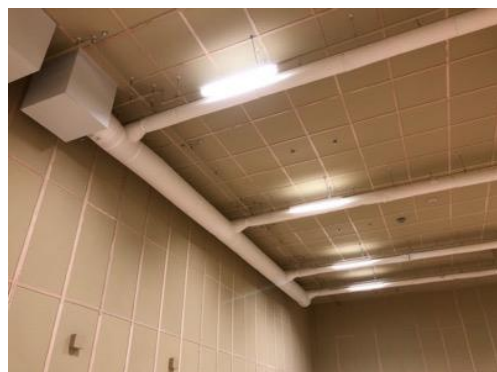
図5 ソックダクトを用いた収蔵庫内の空調
